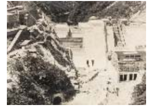
建設中の三面ダムと三面発電所の様子 (旧朝日村、現在の村上市)
