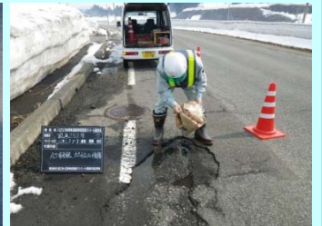
舗装がはがれ、穴が空いた状況。タイヤの通り道が傷みやすい。
