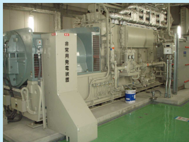
📷 新潟臨海工業用水道に新設された非常用発電機
