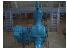
■ 送配水ポンプ (新潟臨海工業用水道)
