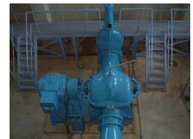
■送配水ポンプ (新潟臨海工業水道) 工場へ水を送ります。
