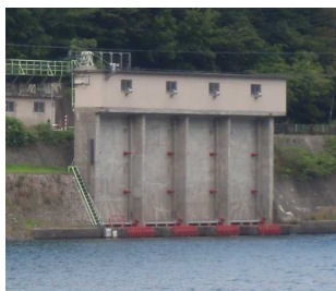
■取水口 (新潟臨海工業水道) 取水口から水を取り入れます。
