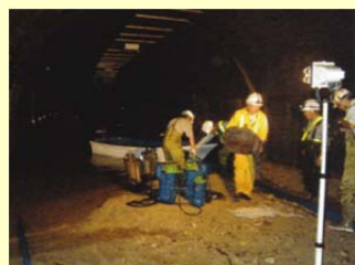
平成 23 年 7 月豪雨による冠水。トンネル内に浮かべたボートで排水ポンプを運ぶ。
