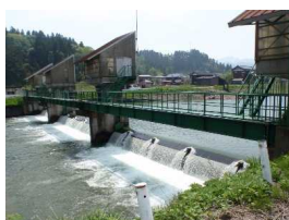
栃尾工業用水道 (長岡市)
