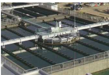
■高速凝集沈殿池 (新潟臨海工業用水道)
