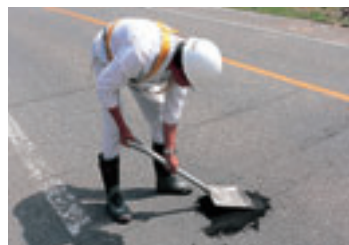
陥没箇所は早急に復旧します。
