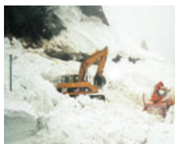
雪崩により道路に崩落した雪処理の様子
